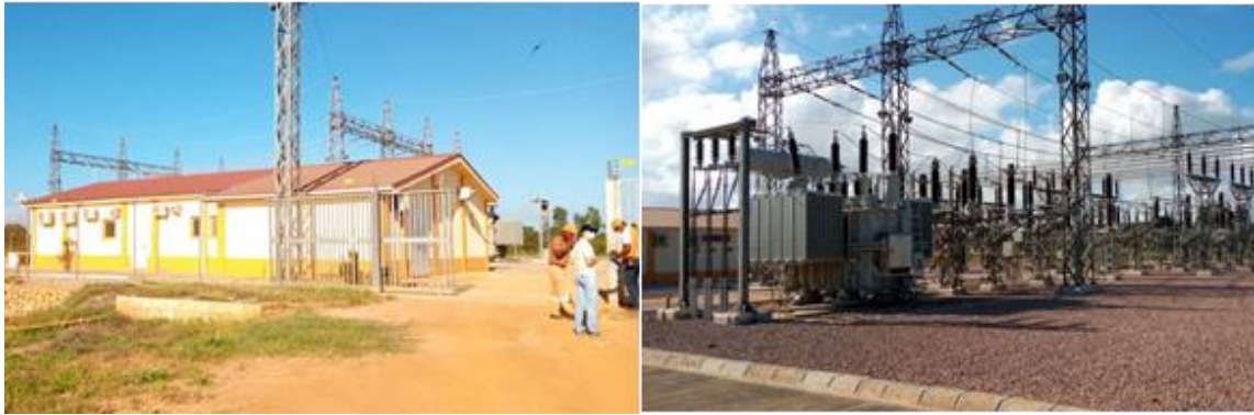
Figura 1. Subestação eléctrica de Massinga
